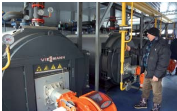
В модульной котельной поселка Веселого.
